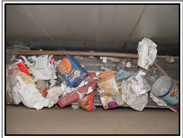
Fig. 3 - Particolare del fondo del convettore presente in una delle aule
