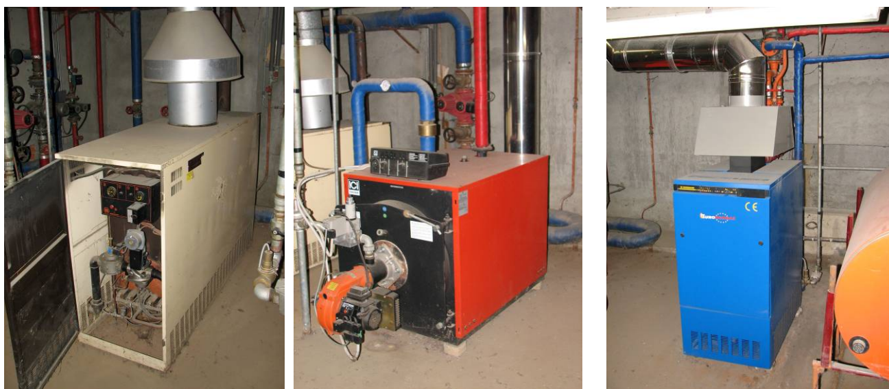
Fig. 20: generatori di calore attualmente presenti
