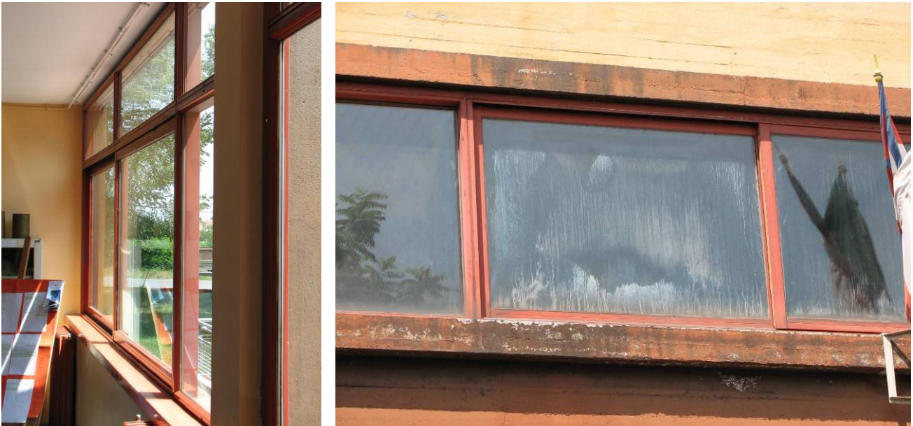
Fig. 3, 4: Stato di conservazione dei serramenti esterni e condensa interna al vetrocamera.
