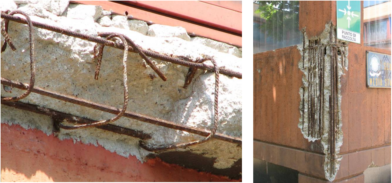
Fig. 1, 2: stato di conservazione di un davanzale esterno e di un pilastro d'angolo.
