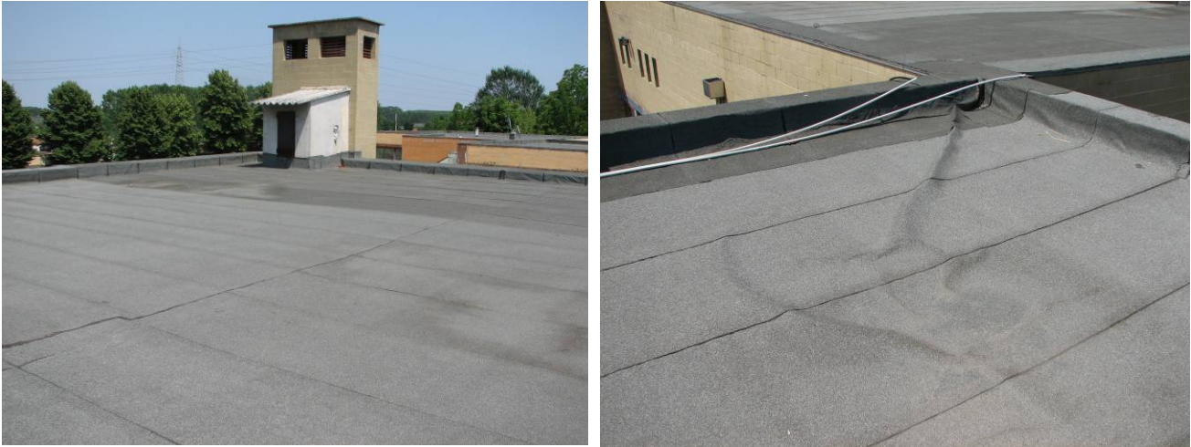
Fig. 5, 6: stato di conservazione della membrana impermeabile e manifestazione patologica.
